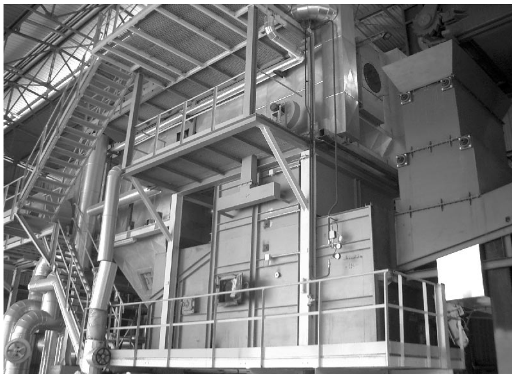
Schon bald in Ems – der erste Block der Biomassenfeuerung aus Rondchâtel.
