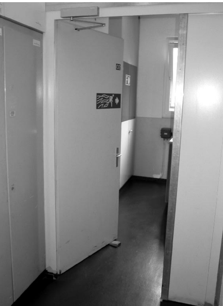
Durch Keil unwirksam gemachte Brandschutztüre.
