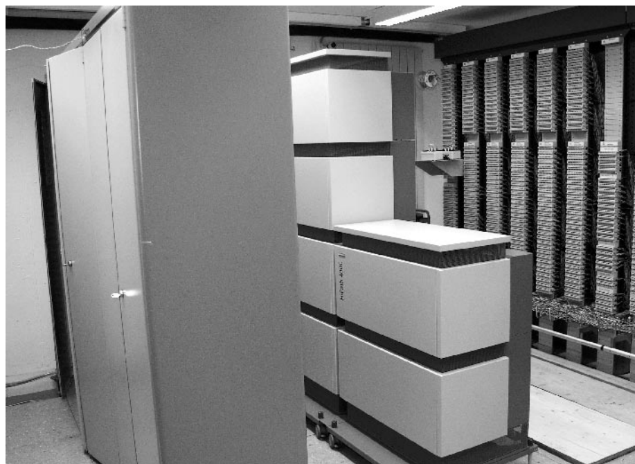
Links die alte, in der Mitte die neue Telefonzentrale. Rechts der zentrale Verteiler
